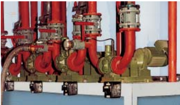
Pompe à engrenages TF-GKGM dans entrepôt de citernes de liant
