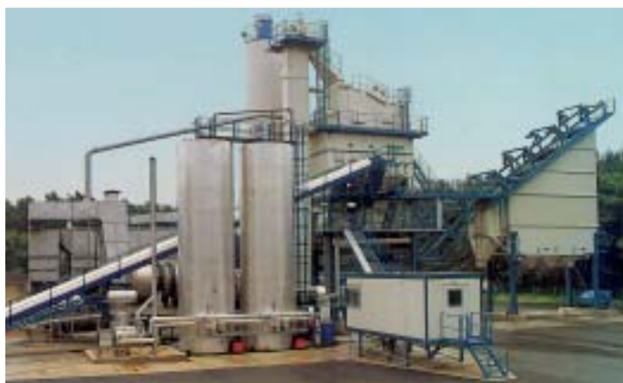
Installation d'enrobage de bitume
